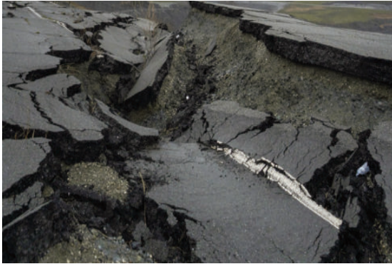
Mặt đường giao thông bị bầm nát sau một trận động đất 6,1 độ richter tại New Papua
