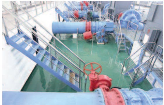
Nước đã qua xử lý tại Nhà máy nước Tây Châu (Quảng Châu, Quảng Đông).
