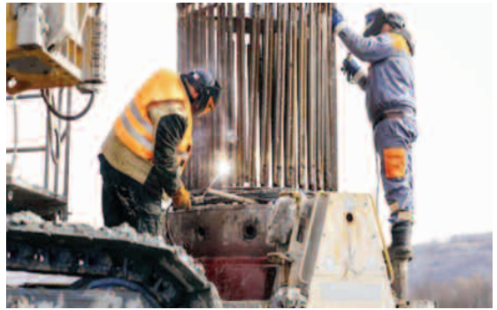
Hỏa hoạn là một vấn đề thực tế và hiện hữu tại các công trường xây dựng.
